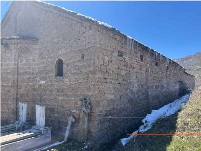
Degradim i kontraforteve
