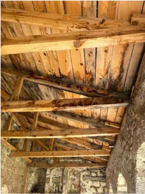
Degradim te tirantave te drurit
